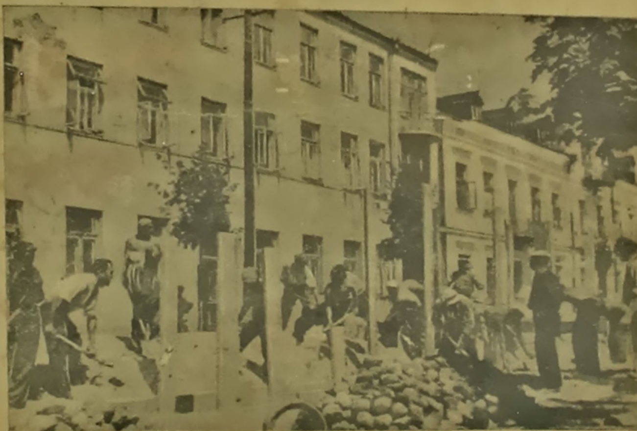
Каля 2 кілометраў каналізацыйных труб пракладзена ў гэтым годзе ў г. Брэст. На здымку: Каналізацыйныя работы на вуліцы імя Маякоўскага.
